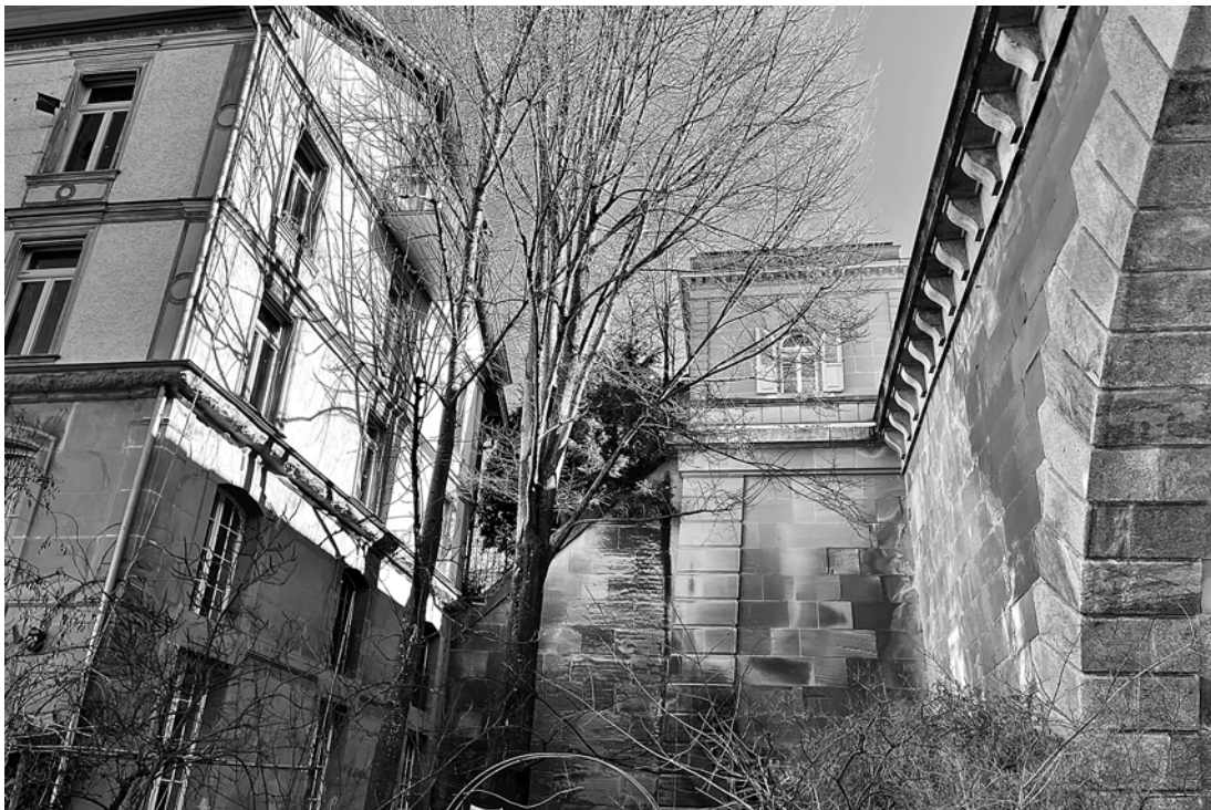
▲ Die dunklen Stellen zeigen: Hier ist der Sandstein völlig durchnässt. Am rechten Rand des Fotos ist die Granit-Seitenverkleidung der Mauerbögen zu erkennen. Als einziger Brückenbogen ist der Mittelbogen komplett aus Granit gebaut, weshalb er keine grossflächigen Wasserschäden aufweist.
