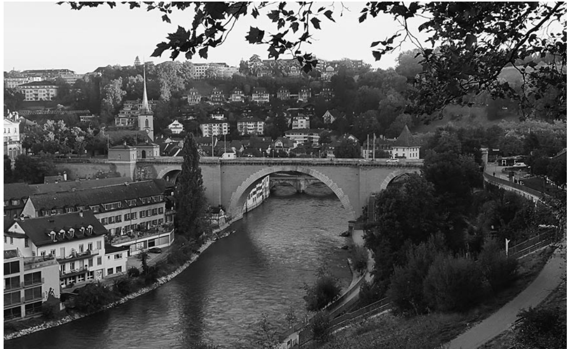
▲ Stolz spannt sich der mächtige Mittelbogen der Nydeggbücke über die Aare. Die Distanz verdeckt gnädig die Schäden, die bei der geplanten Gesamtsanierung in zwei Etappen beseitigt werden sollen, die zwischen Frühjahr 2025 bis Herbst 2026 und dann wieder zwischen Frühjahr 2029 und Sommer 2030 geplant sind. Foto: zVg
