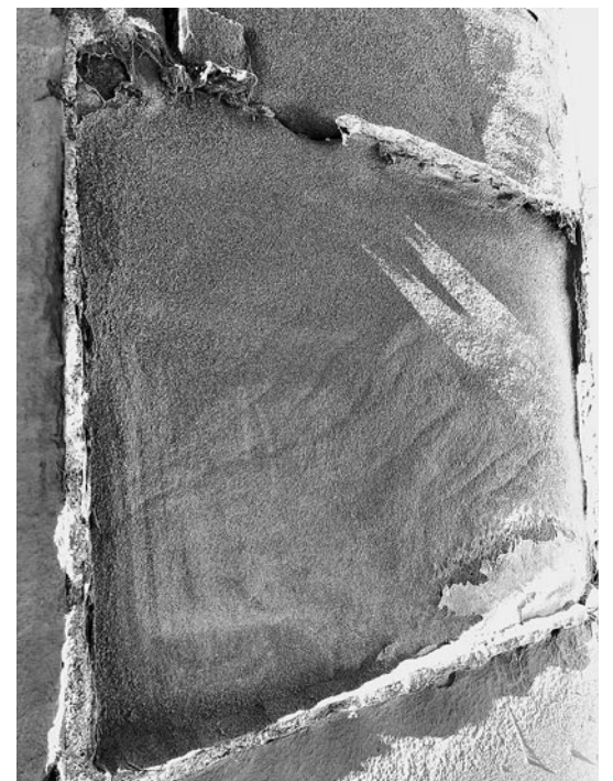
▲ Dieser Sandstein ist gleich zweifach beschädigt, durch Absandung und die Verwitterung der Mörtelfugen, beides ist die Folge von Nässe.
