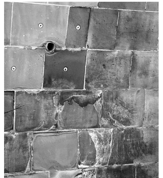
▲ Wenn man sich die Wand im Brückenbogen anschaut, scheint dieses sehr provisorisch anmutende Abflussrohr nicht wirklich wirksam gewesen zu sein.
