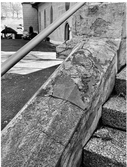
▲ Die Treppenbrüstung am Nydegghof ist vielfach gerissen, hier kann das Regenwasser ungehindert in den Stein eindringen.
