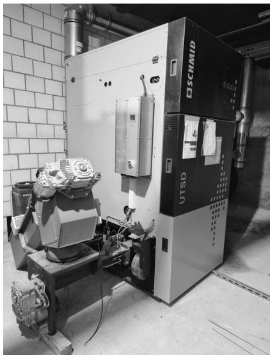
▲ Die neue Pelletheizung steht im «Maison Capitol». Links im Bild die automatische Einfüllung. Die Aufnahme stammt von Anfang Oktober 2021, die Heizung ist noch nicht angeschlossen.
