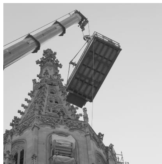
▲ Rechts: der seit 2005 altgediente Materiallift, seine Tage sind gezählt. Mitte: Schwerer Brocken auf Lieferplattform wird Richtung Haspelboden gehievt. Einmal dort montiert wird der nigelnagelneue Kraftprotz mit vertauschten Rollen seinerseits Lasten und allergattig Material in die Höhen des Münsterturms heben.
