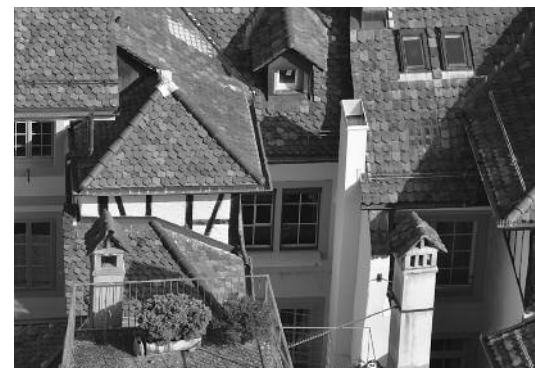
▲ Stark verwinkelte Dachformen mit exponierten, nicht einseharen Untersichten und toten Winkeln in Lichthöfen. Durch Feuerwerk verursachte Glimmbrände könnten sich unbemerkt entwickeln.
