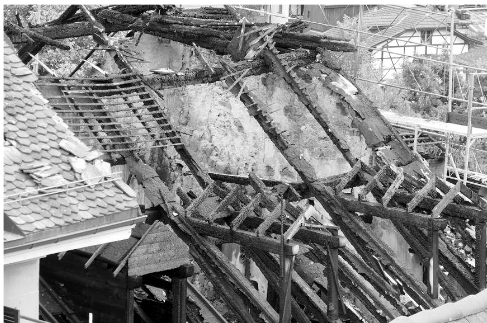
▲ Am Tag danach: Blick auf den ausgebrannten Estrich des Morell-Hauses. Noch liegt leichter Brandgeruch in der Luft, doch hatte eine Brandwache rund um die Uhr den Gefahrenherd im Auge. (Foto: babü)
