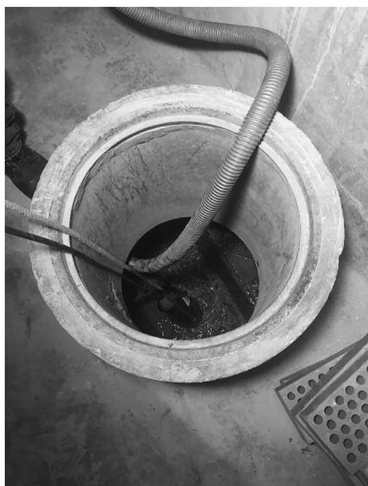
▲ Die Pumpe im Keller des Schulhauses...
