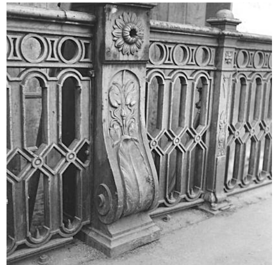
▲ Kurz vor dem Abriss: Detail des dekorativen gusseisernen Geländers, das 1972 durch Leichtmetall ersetzt worden ist. Die Brücke besass ursprünglich beidseitig 2.4 Meter breite Trottoirs. Auch die ursprünglich vorhandenen schönen Kandelaber sind heute verschwunden. (Burgerbibliothek Bern, FP B.1052)
