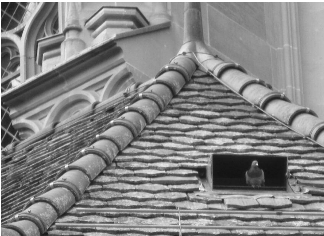
▲ Einflugloch im Dach des Münsters, hoch über dem Osteingang zur Plattform
